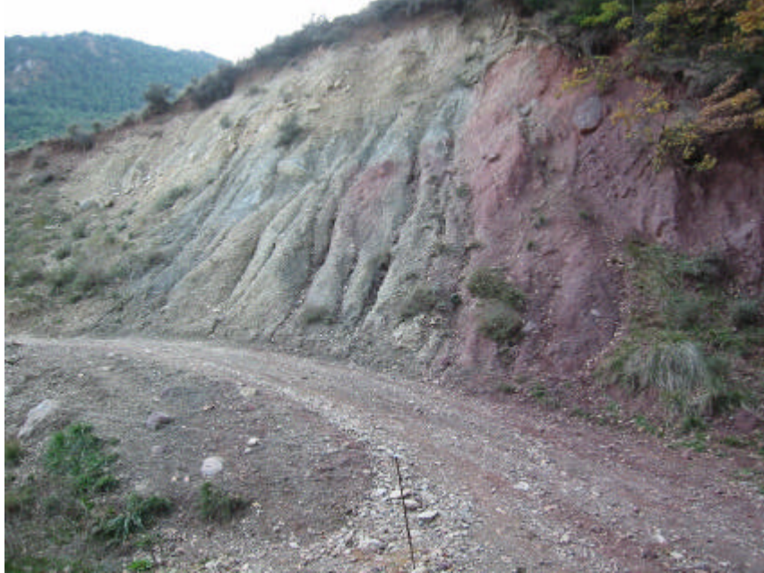
Fotografia 15: Marge d'un camí del sector constituït per argiles i llims violats, afectat per xaragallaments puntuals.
