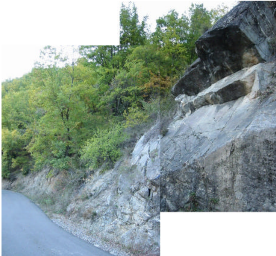
Fotografia 18: Exemple de cicatriu de despreniment al talús de la carretera que transcorre per sobre cal Paraire, (a, plànol 5). Observar que l'estratificació cabussa a favor del pendent.
